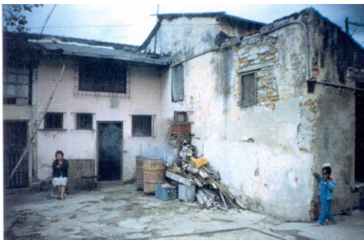
Una de las ciudadelas de El Cerro antes de ser intervenida por ASF
