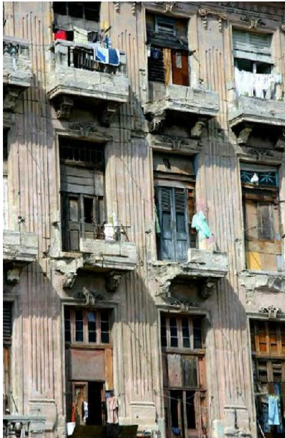
Una de las consecuencias del embargo contra Cuba ha sido el deterioro de la mayoría de las construcciones del país. En la foto, un bloque de pisos en La Habana.
